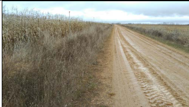
Abundante vegetación en cunetas
