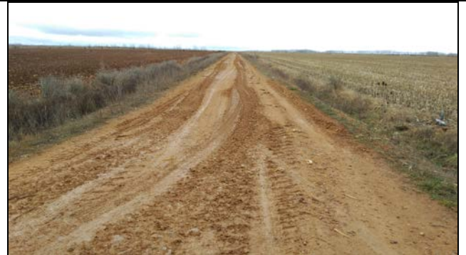
Camino con mal firme
