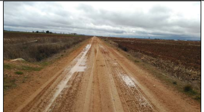
Camino con mal firme
